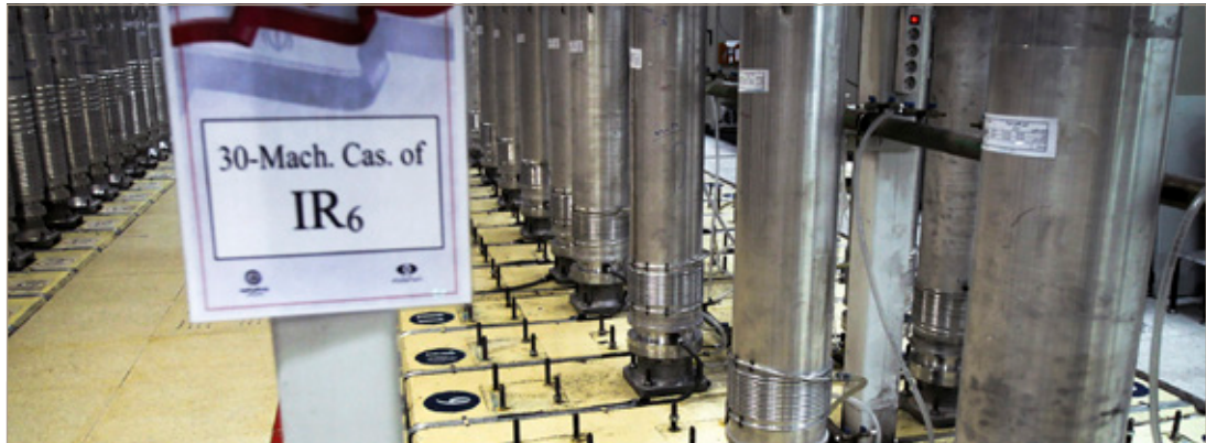
Bilde: Sentrifuger ved Irans anrikingsanlegg i Natanz.
